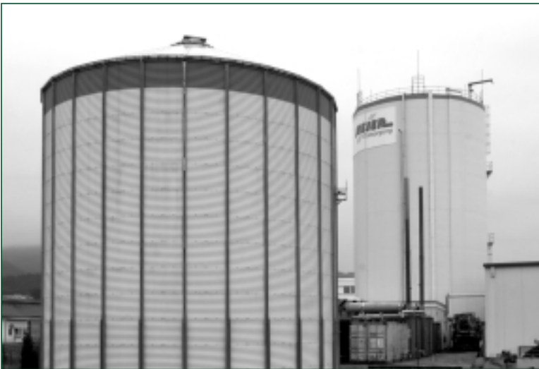
Gärreaktor des Biogas- und Kompostbetriebs Freiburg (BKF)
